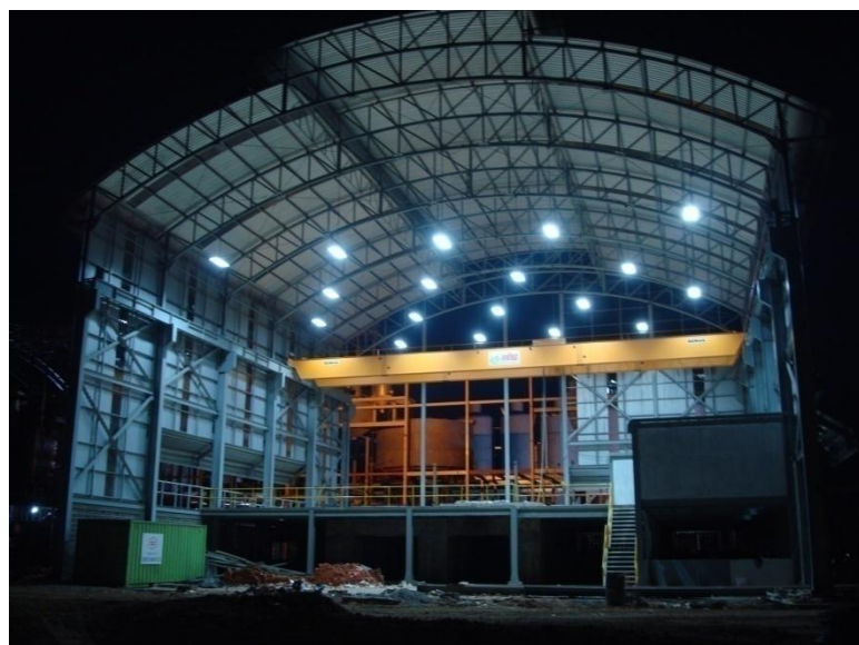
ติดตั้ง ไฟประหยัดพลังงาน 220w แทนโคมแสงจันทร์ กำลัง 400w
